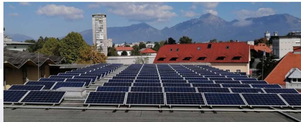
Sončna elektrarna na strehi upravne stavbe MOK
